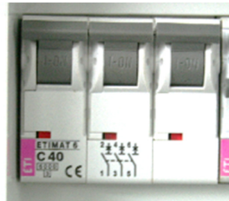
Schutzschalter für Versorgung der Wärmepumpe Luft - Wasser (WPL, WPLV).
